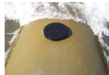
Verschluss/Sicherung der Einfüllstutzen
