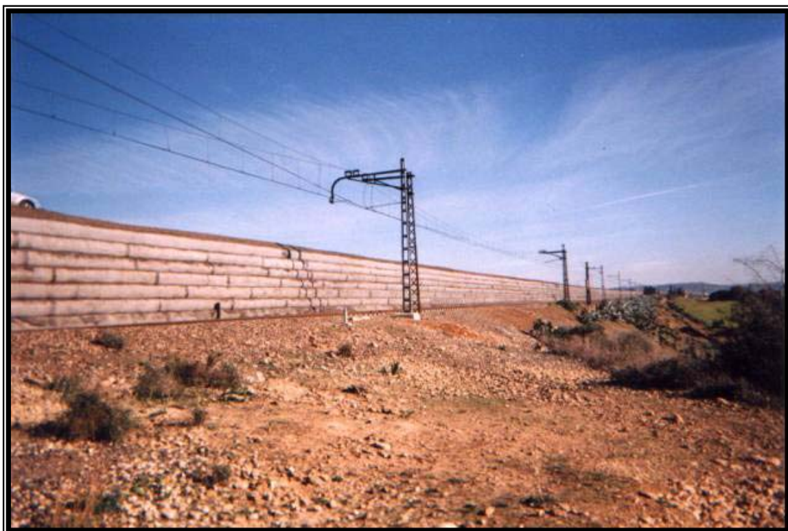
Photo 1: Dédoublement de la voie ferroviaire Meknes-Fes : remblai temporaire renforcé 1. à l'aide de géogridde Fortrac.
