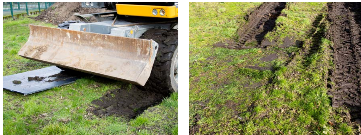
Basetrac Plate im Einsatz: Umgebung ohne Schutz zeigt massive Verdichtung und Spurrillen
