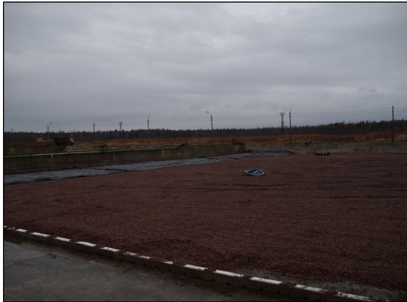
Abbildung 8: Permanente Lagerungsfläche und Entwässerungsfeld, bestehend aus einer Stahlbetonwanne mit Drainageschicht und zur Befüllung vorbereiteten Entwässerungsschläuchen im Hintergrund
